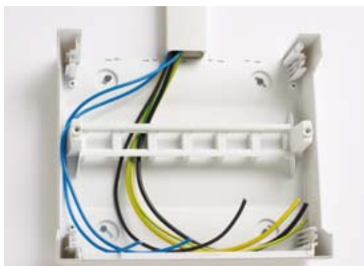
Spațiu optim de cablare
